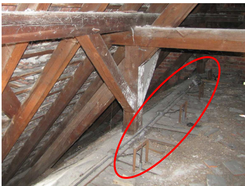
Fot. 3. Wszystkie stalowe łączniki oczyścić i zabezpieczyć antykorozyjnie za pomocą powłok malarskich
