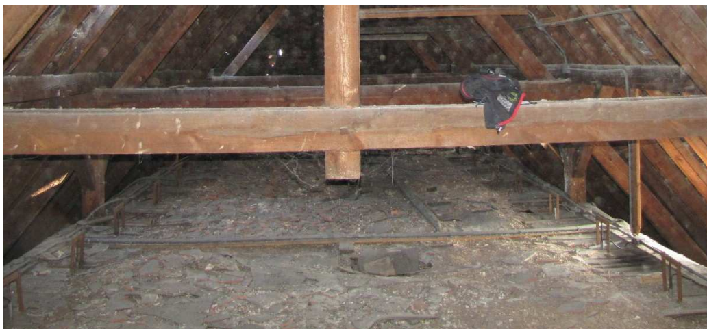
Fot. 1. Na stropie zalega gruz, który należy usunąć; deski podłogowe stropu w bardzo złym stanie technicznym – w całości do wymiany
