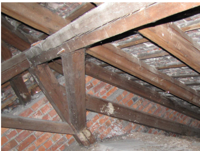
Fot. 2. Większość elementów drewnianych więźby znacznie popękana
